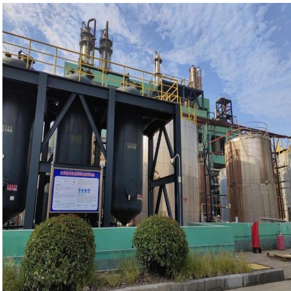
氯化苯中间罐区
